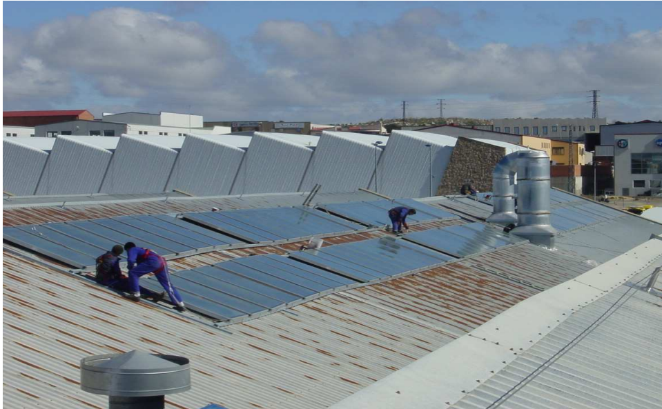
Instalación solar industrial
