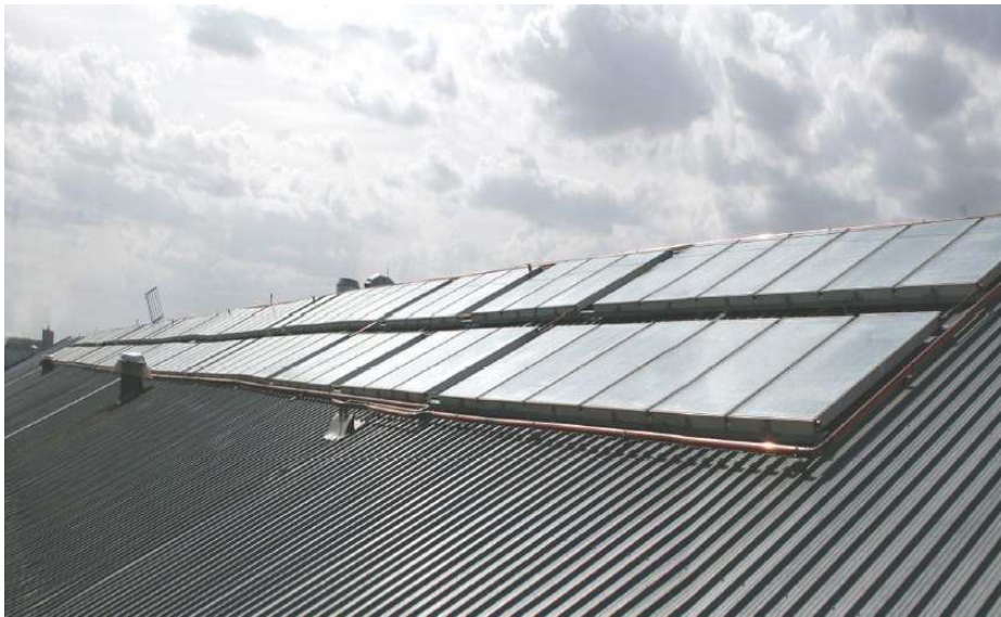
Instalación solar térmica en industria
